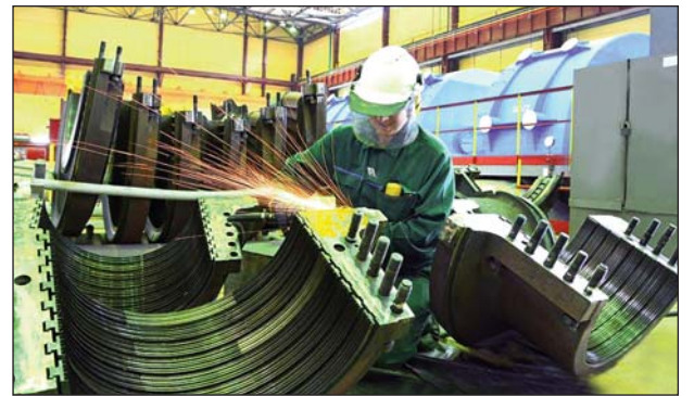
На Рівненській АЕС — реалізація програми НАЕК «Енергоатом» щодо заміни засобів оснащення для проведення технічного обслуговування і ремонту обладнання, яка розрахована на 2018–2020 роки
